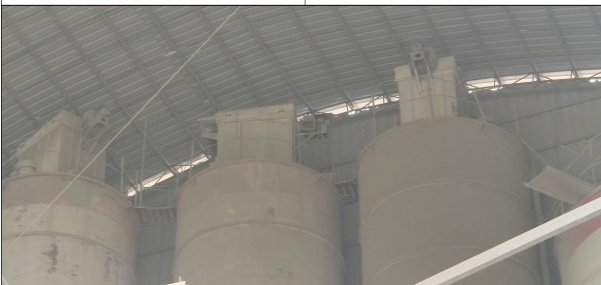
筒仓仓顶脉冲式除尘器
