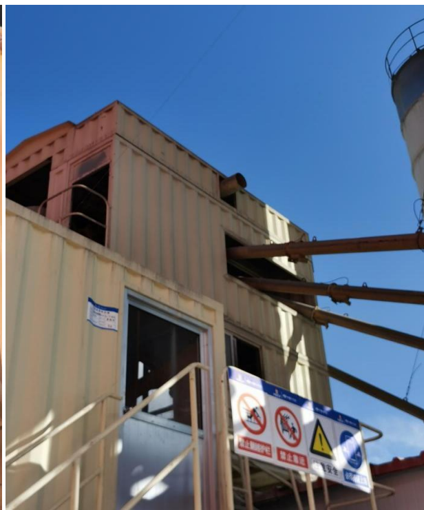
拌合楼除尘器排气口
