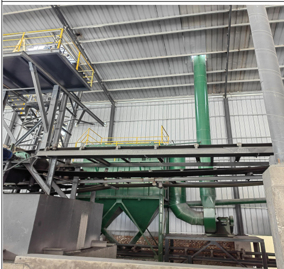
进料区布袋除尘器+18m 高排气筒
