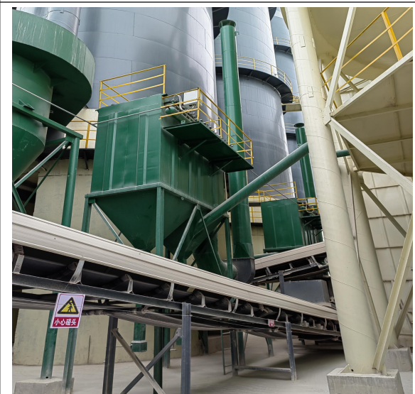
布袋除尘器+18m 高排气筒
