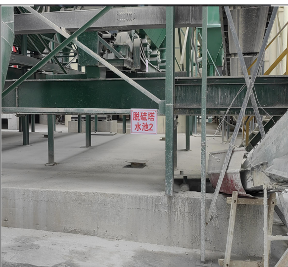
脱硫塔循环水池
