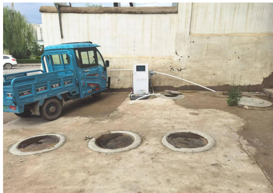
化粪池、消毒池
