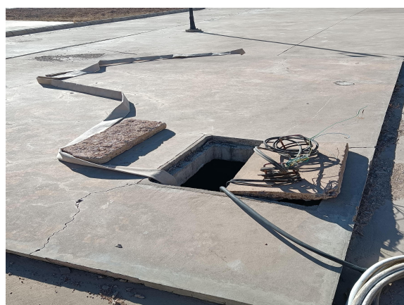
事故油池（刘园子变电站）
