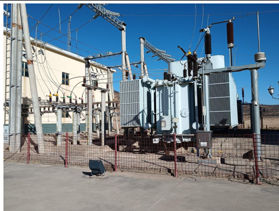
主变（刘园子变电站）
