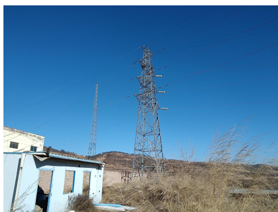
环刘 124#塔与阜刘 316#塔同塔双回架设基塔
