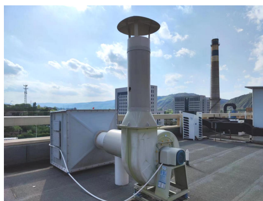
理化实验室废气排放口
