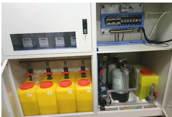
污水处理站内设置的各加药罐
