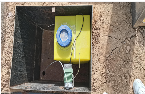
地埋式污水处理站加药箱
