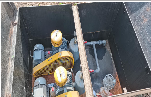
地埋式污水处理站风机间
