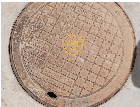
污水管网检查井
