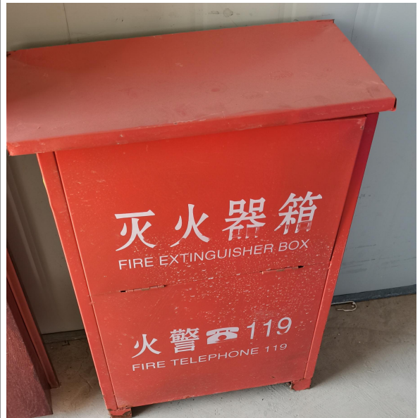
医疗废物暂存间灭火器
