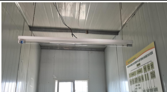
医废暂存间固定式紫外线消毒灯
