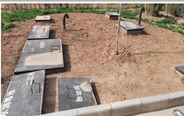
地埋式污水处理站
