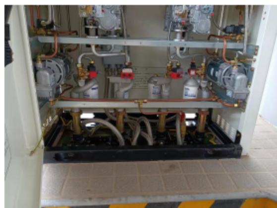
油气回收设备
