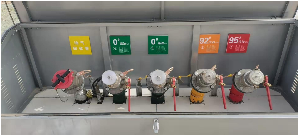
油气回收装置
