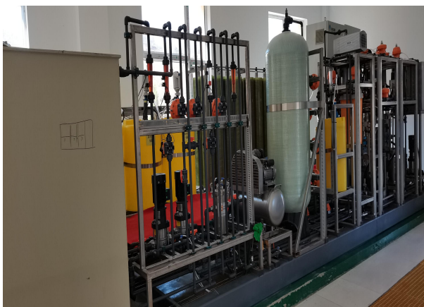
渗滤液处理一体化处理装置
