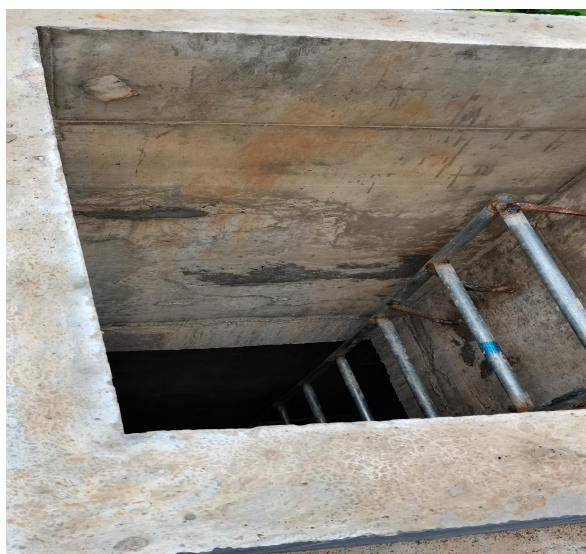
管理区消防水池
