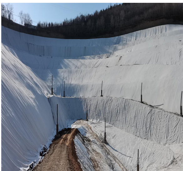
填埋区导气笼井
