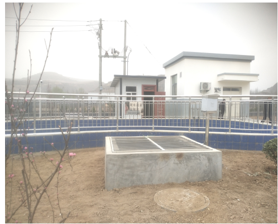
景观池（接触池）
