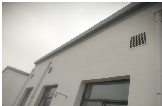
设备间排风扇外接口
