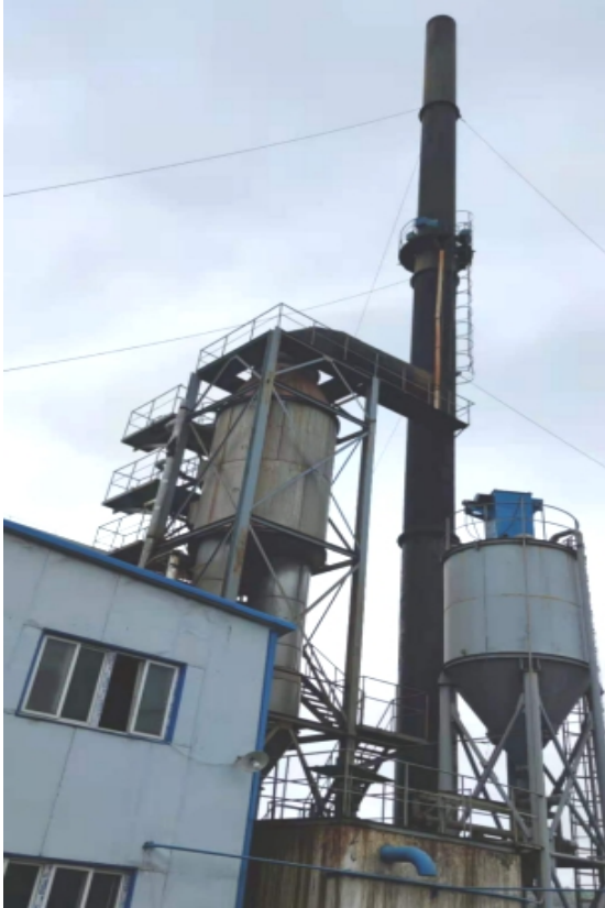
烟气处理设施（脱硫塔）
