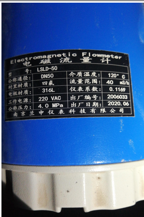
污水处理站电磁流量计铭牌
