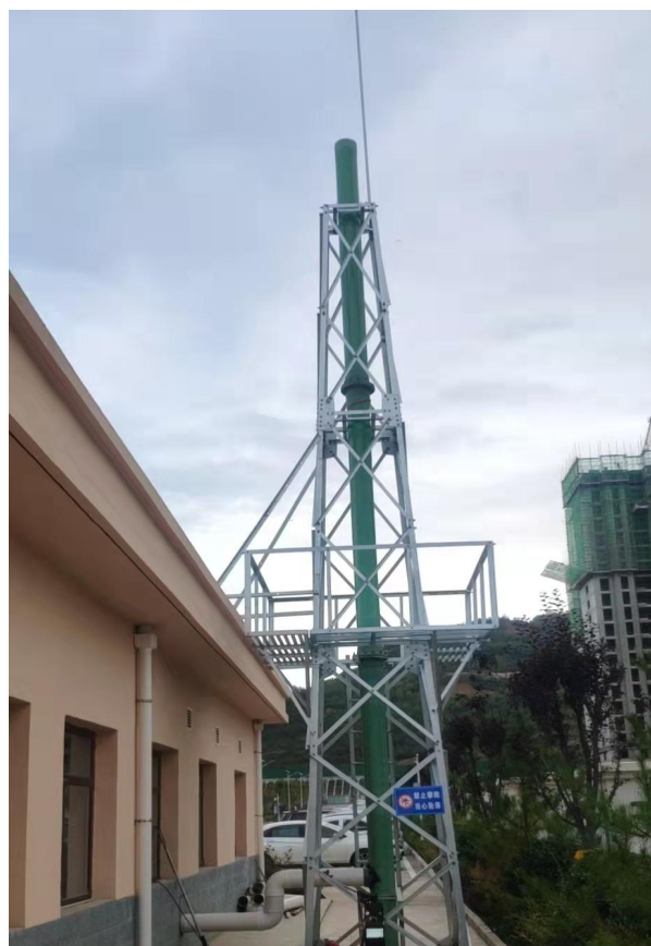
污水处理站脱臭塔排气筒
