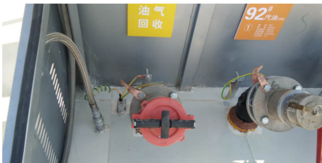
卸油时油气回收装置
