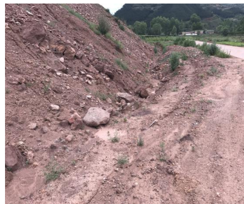
2017 年弃渣场临时排水沟
