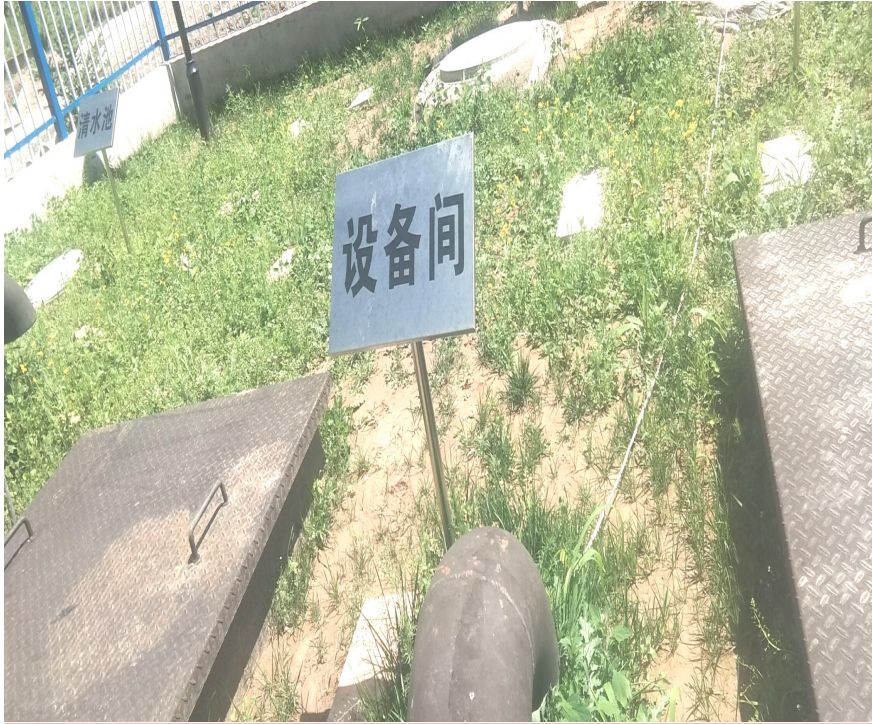
设备间置于地下且加盖
