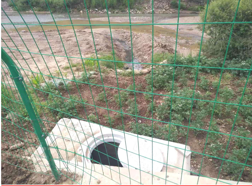
明渠排污口，尾水排入马峡河
