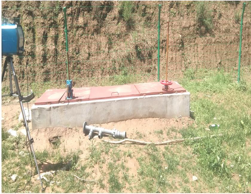
格栅池设置在厂界西北角，且加盖
