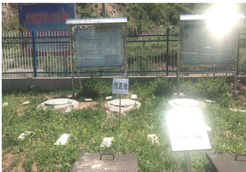
地埋式一体化污水处理设施
