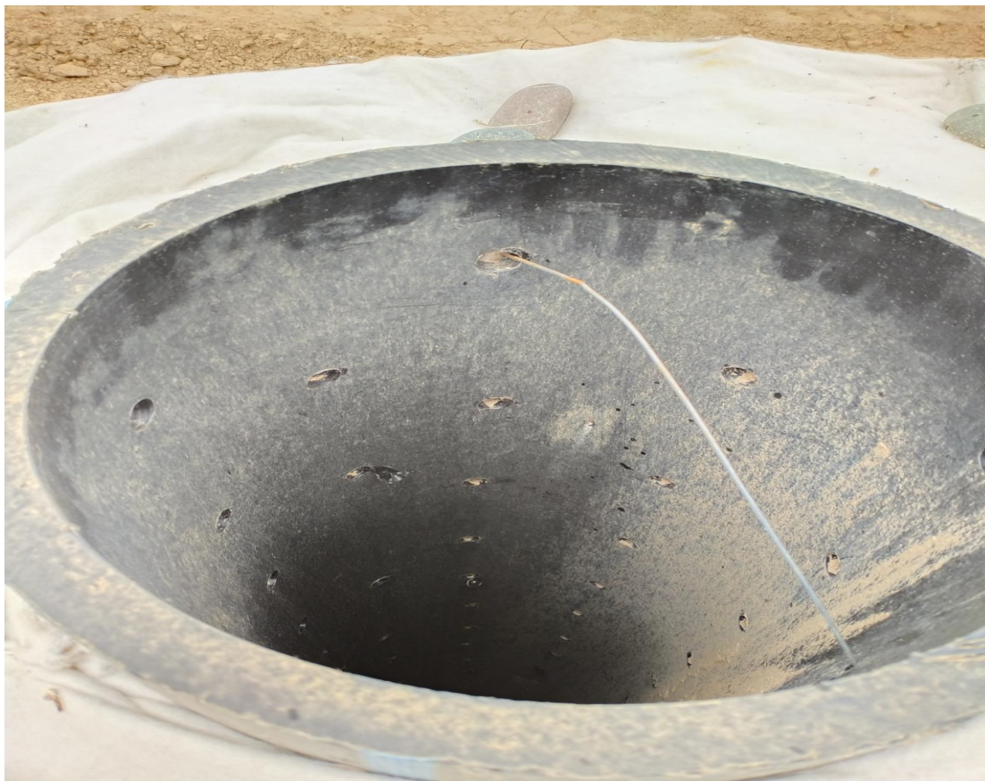
填埋气导气井
