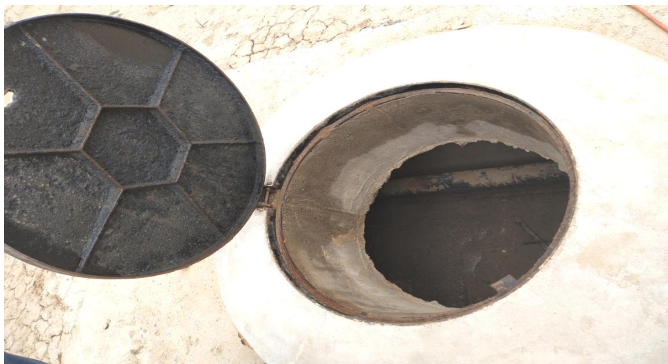
渗滤液回喷管道
