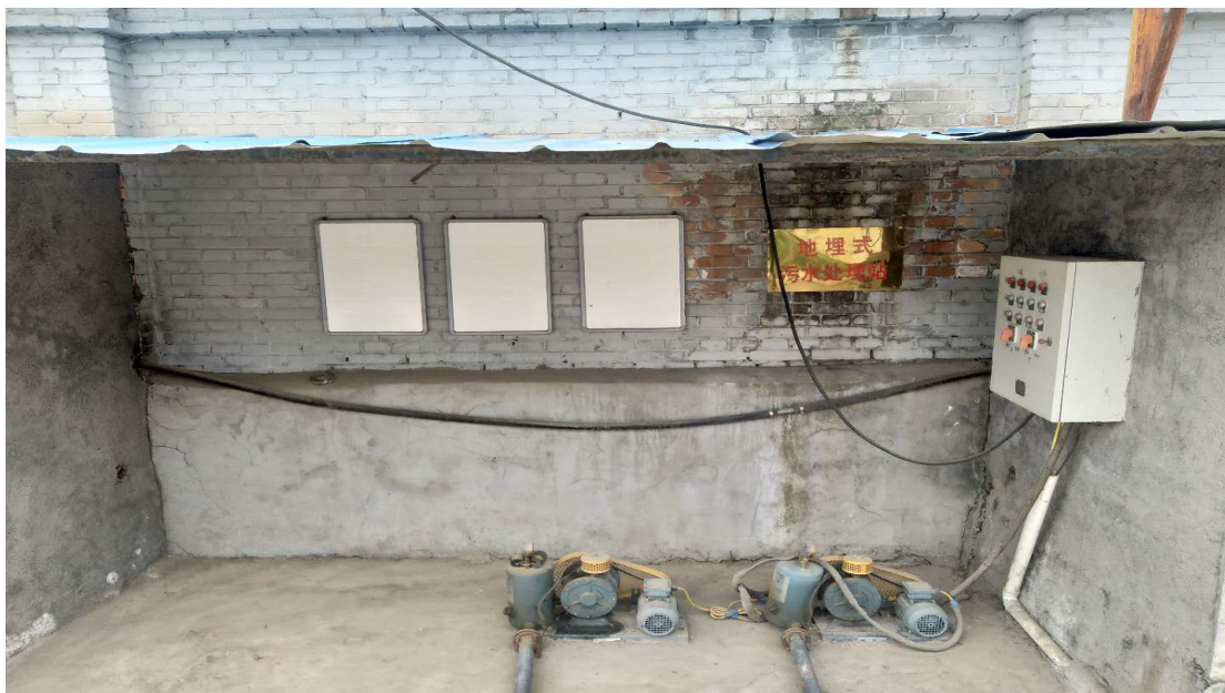
图 3-5 一体化污水处理设施
