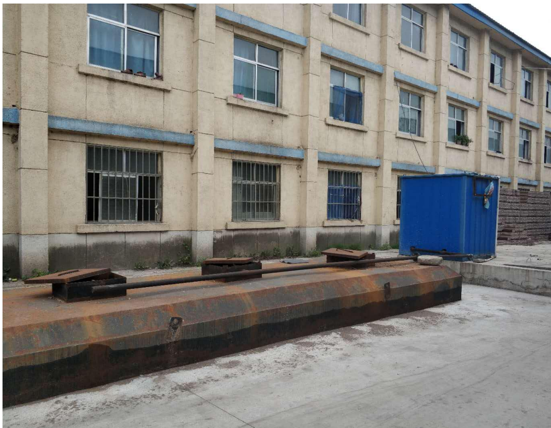
图 3-5 地埋式一体化污水处理设施
