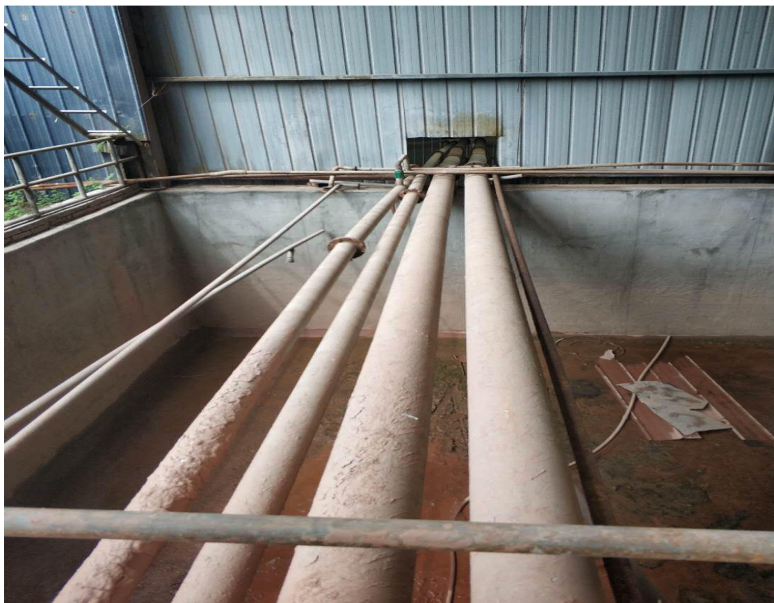
图 3-3 配料输送管道
