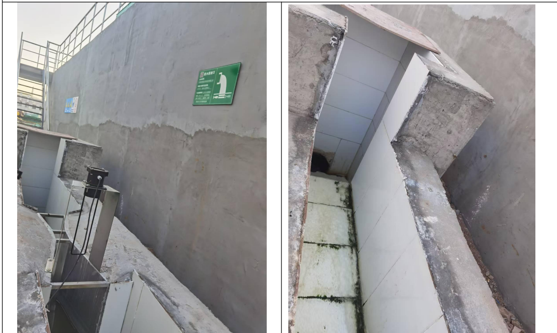
污水总排口（巴歇尔槽）
