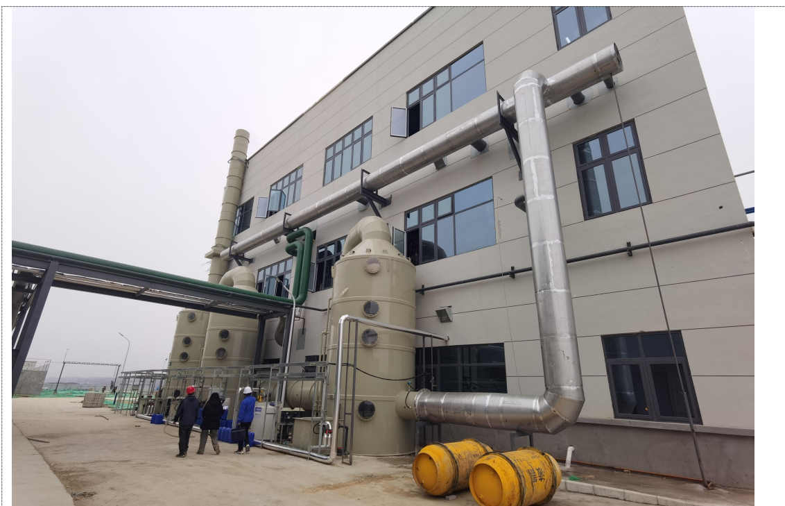
发酵废气处理设施及排气筒
