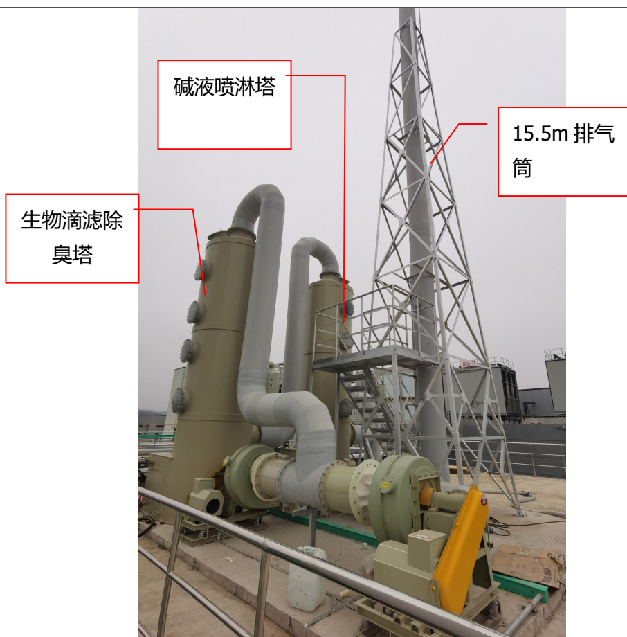
污水处理站废气处理设施
