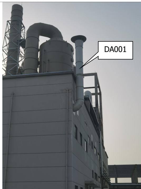
原料磨制废气排气筒（DA001）
