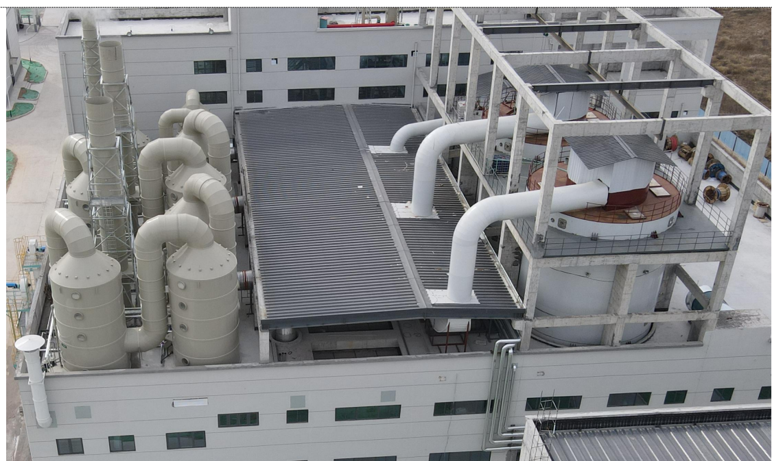
干燥塔废气处理设施
