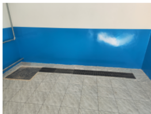
集液沟、集液池
