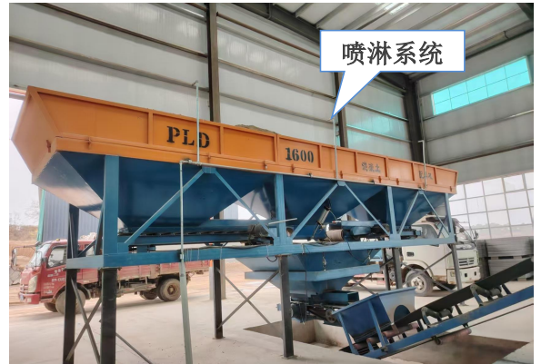
透水砖上料口喷淋系统
