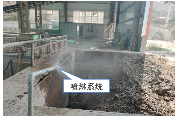
建筑用石上料口喷淋系统
