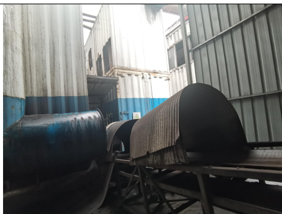
旋风除尘器+布袋除尘器+除尘煤输送带
