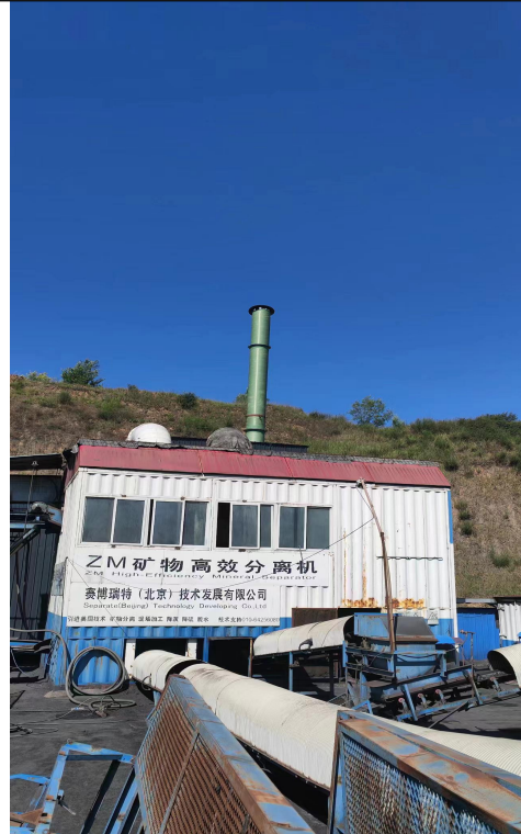
20m 高排气筒
