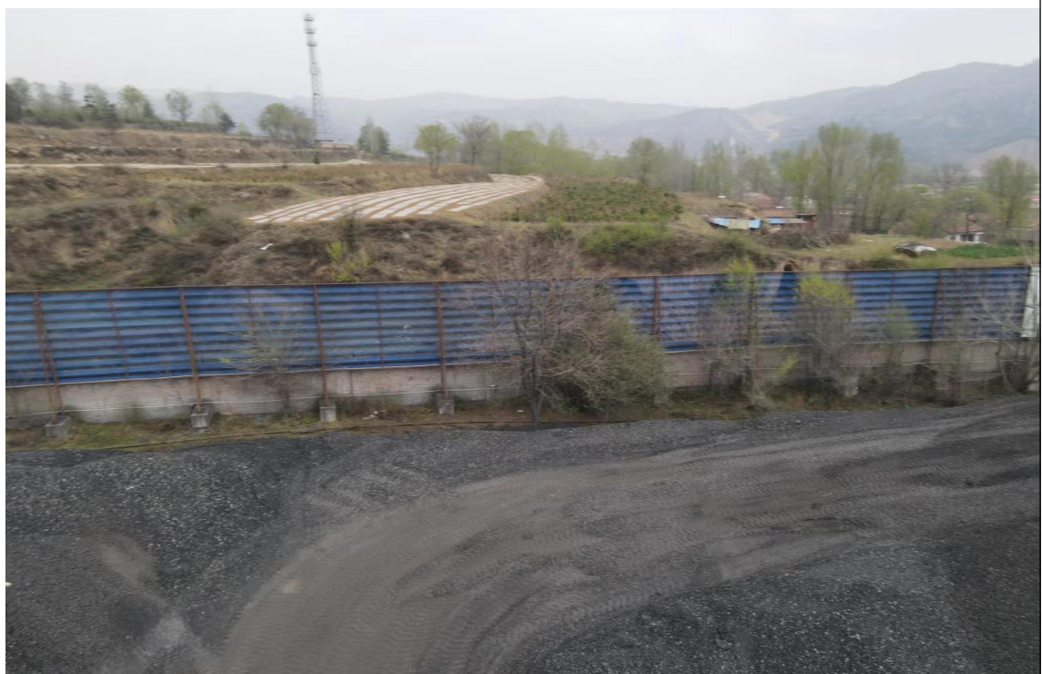
储煤场抑尘网围挡
