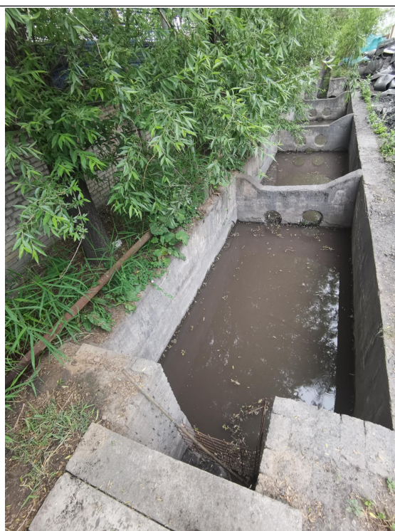
50m 3 煤水收集沉淀池
