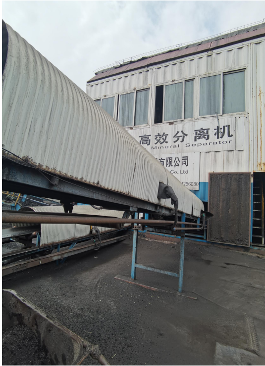
导料槽密闭挡帘
