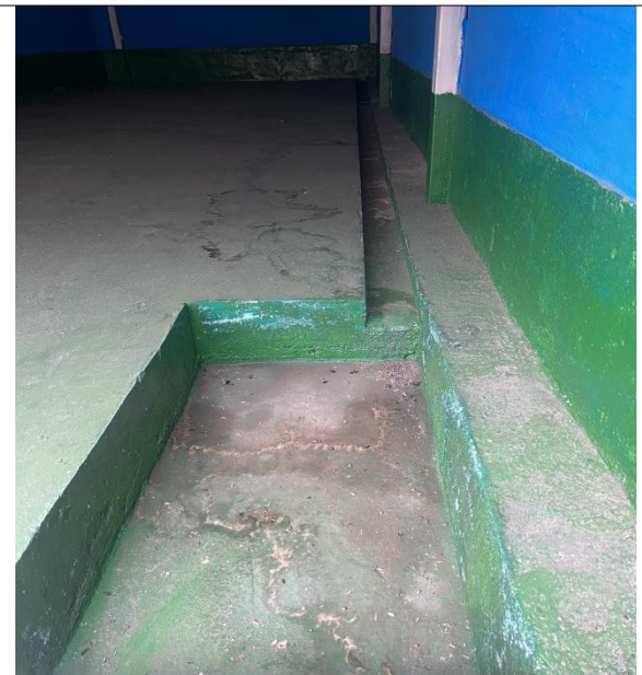
废油桶间导流槽及应急池
