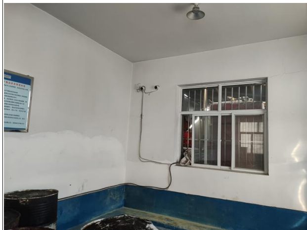
废矿物油间视频监控
