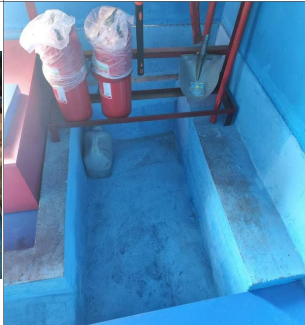
废铅蓄电池间防渗及其应急池
