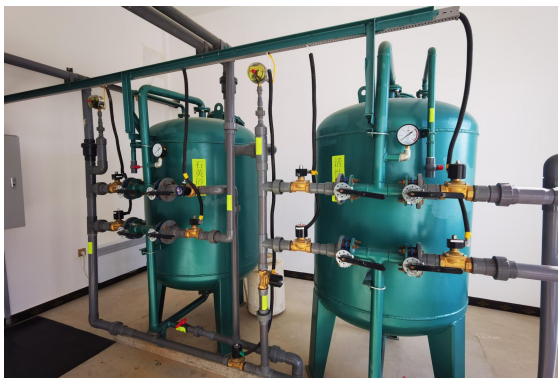
石英砂过滤及活性炭吸附装置
