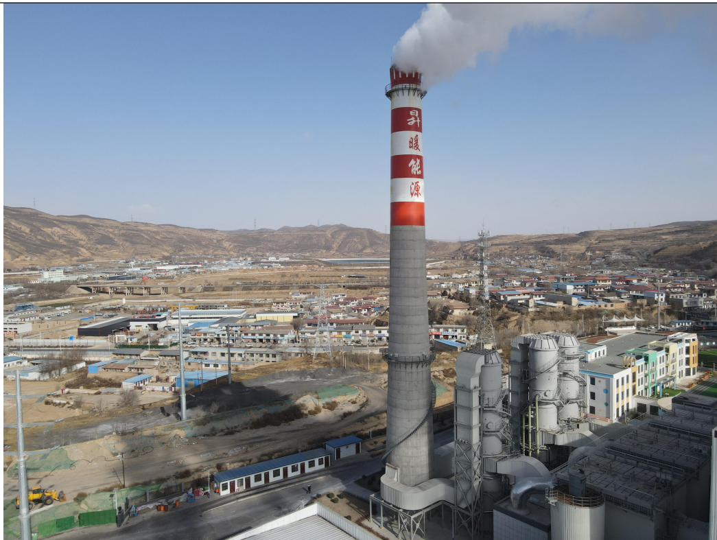
燃煤锅炉80m高排气筒（DA001）
