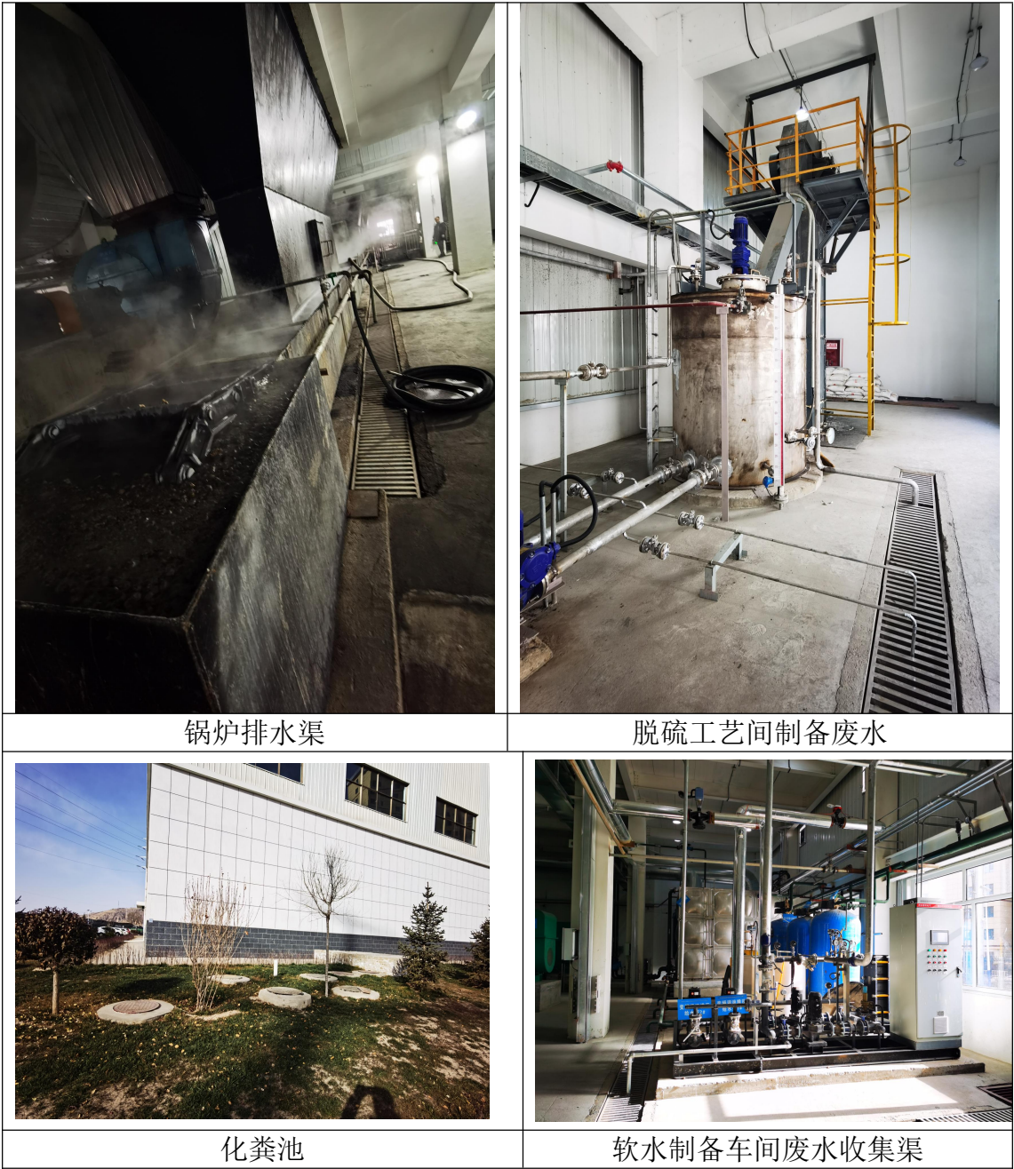
图5-1 污水治理设施图片
