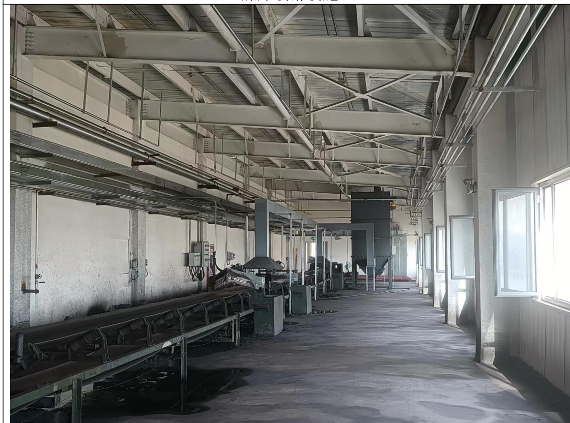
上煤系统及炉前煤仓粉尘收集及布袋除尘器处理设施
