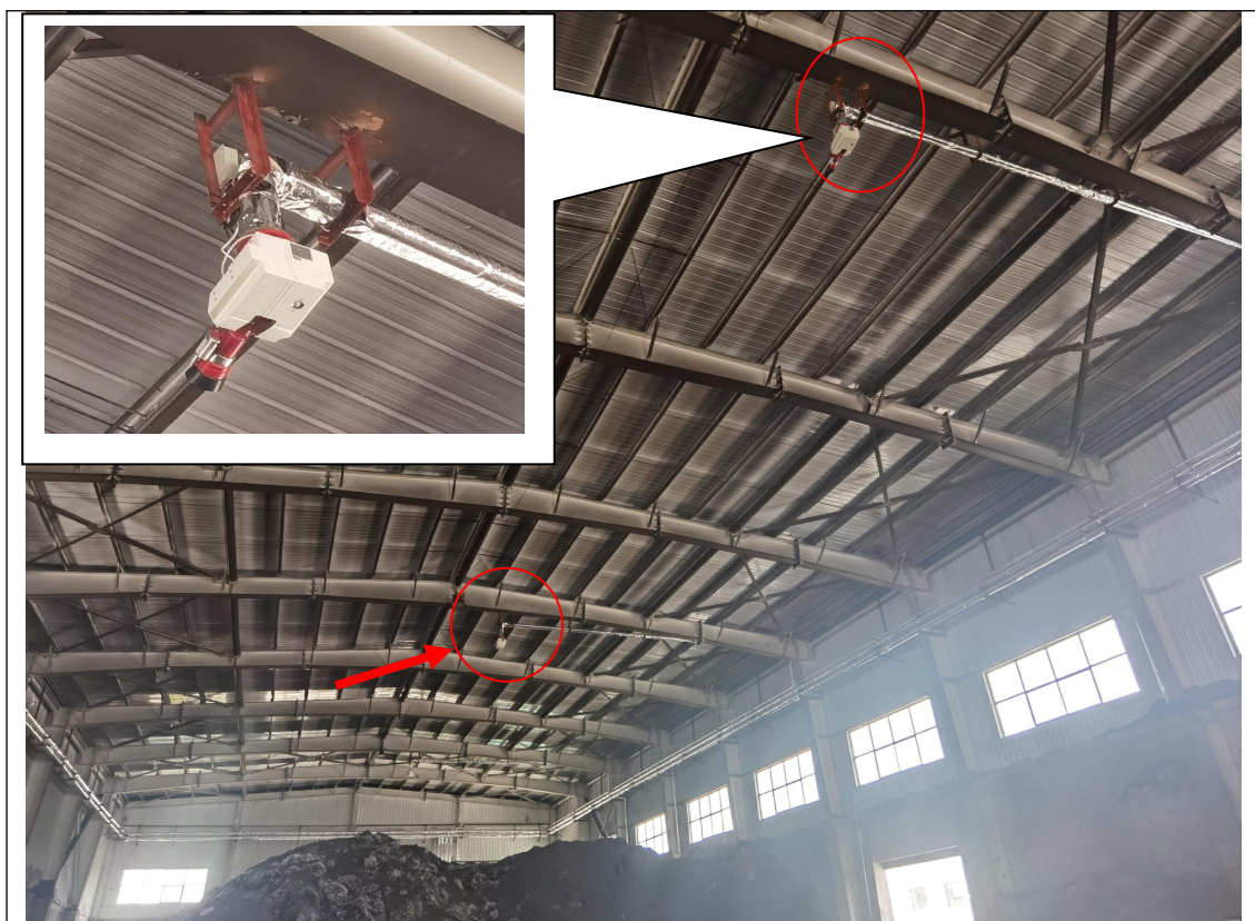
煤库喷淋设施
